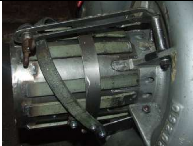
3. ábra A Ganz kompresszor házán kialakított pompázsgátló rendszer
